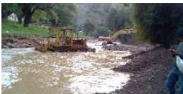
Deslizamiento del Talud Distrito N° 4 – J.V. Glorieta II
