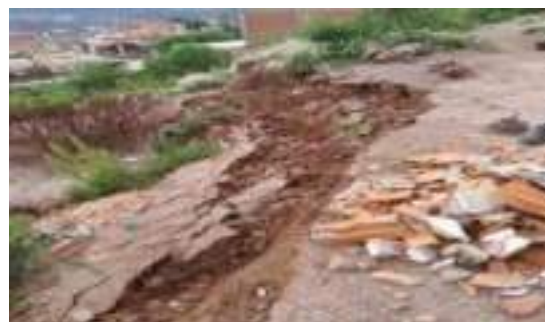
Deslizamiento del Talud Distrito N° 5 – Barrio Villa Socavón
