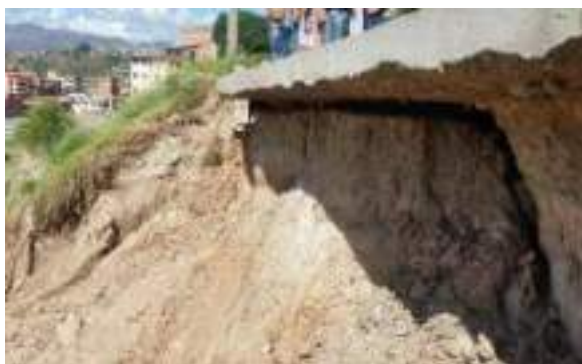
Deslizamiento progresivo del Talud Distrito N° 2 - Barrio Alto Delicias
