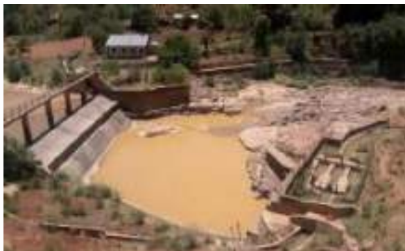
Toma de Aducción Río Ravelo
