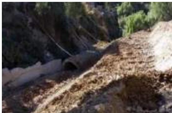
Deslizamiento de Talud Distrito N° 3 – Barrio Asnahuayco
